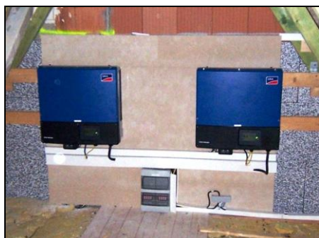
SMA Wechselrichter mit Überspannungsschutz Dach
